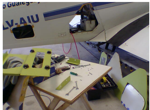
Vista General Instalación
