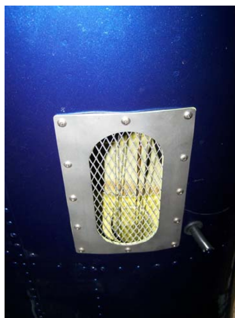
Ventilación Unid. Condensadora (Ingreso)
